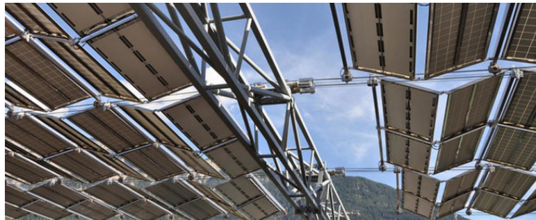
Solar-Faltdach über der Kläranlage in Chur.
